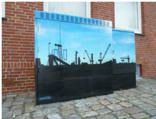
[65] Dit electriciteitskastje wordt actief bij de omgeving betrokken, omdat de afbeelding past bij de havenstad waar het onderdeel vanuit maakt.
